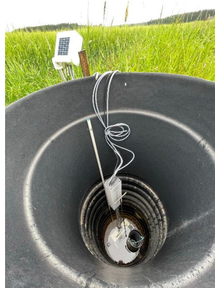
Kuva 3. Talvella 2021/2022 kehitettiin olemassa olevaan säätsalaojakaivoon aurinkopaneelilla toimiva etäohjattava yksikkö. Laitteisto on liitettävissä olemassa olevaan kaivoon.
